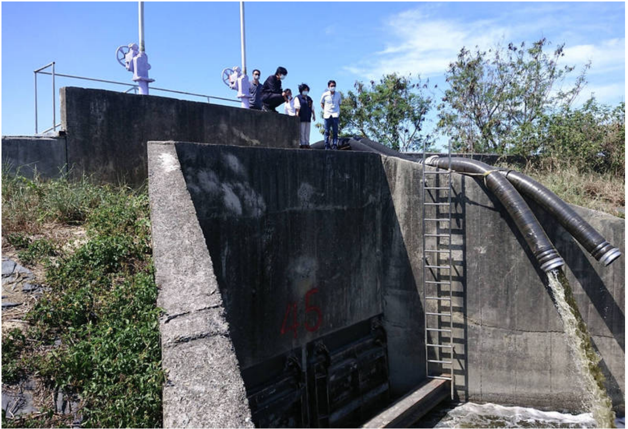
梅雨鋒面報到，南市為防汛整備部署，巡檢抽水站、抽水機、水閘門的運作。（記者楊金城翻攝）
